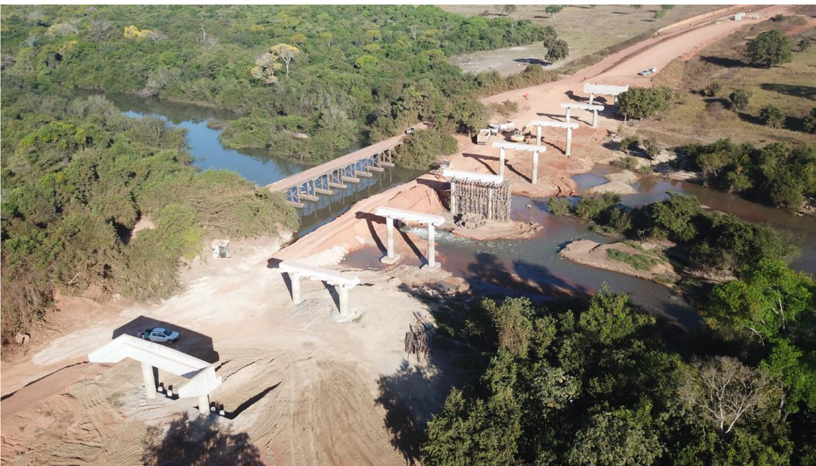
Execução da nova ponte sobre o Rio Pintado, na BR-080, ao lado da antiga ponte de madeira que atendia a região
